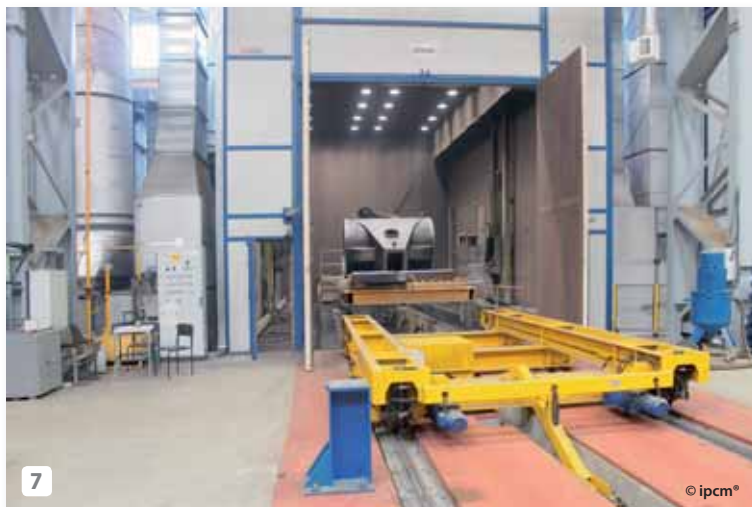
Interno della camera di granigliatura.
